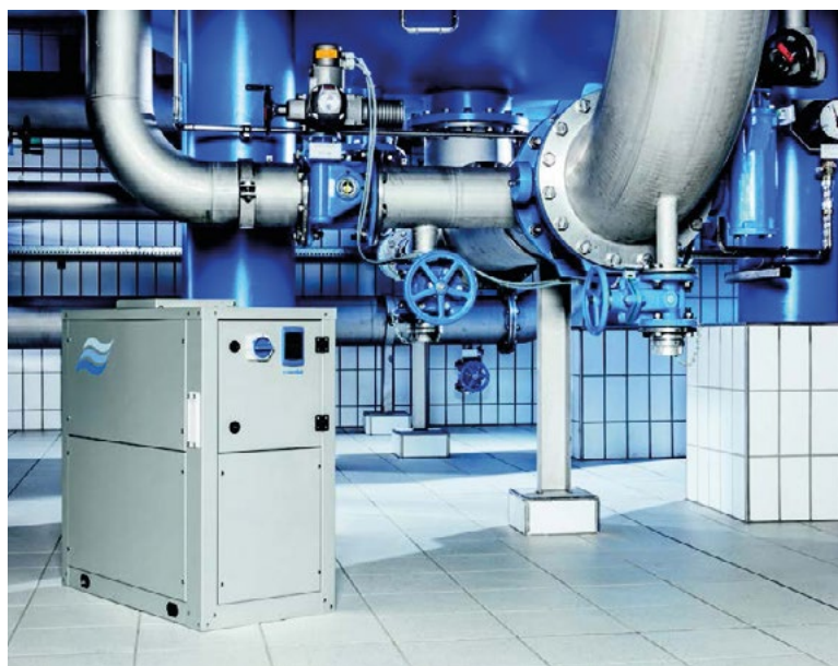
Déshumidification dans l'approvisionnement en eau
