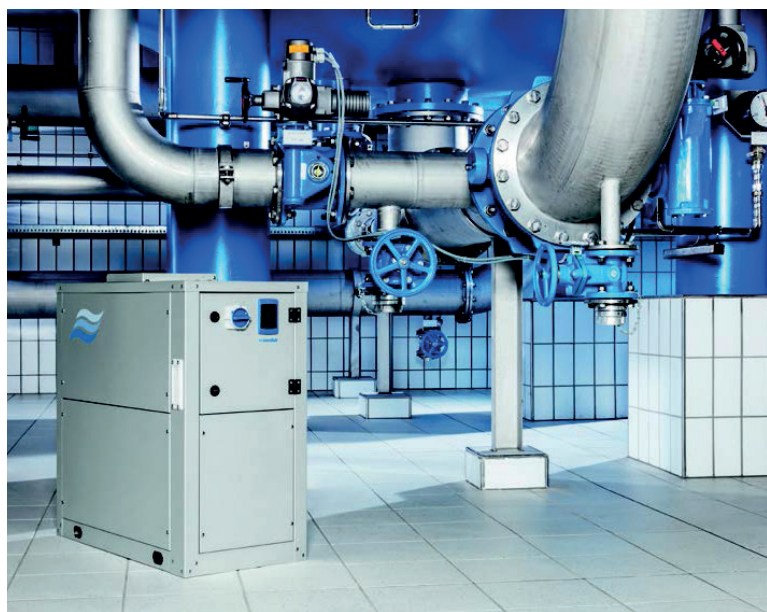
La deshumidificación en el abastecimiento de agua
