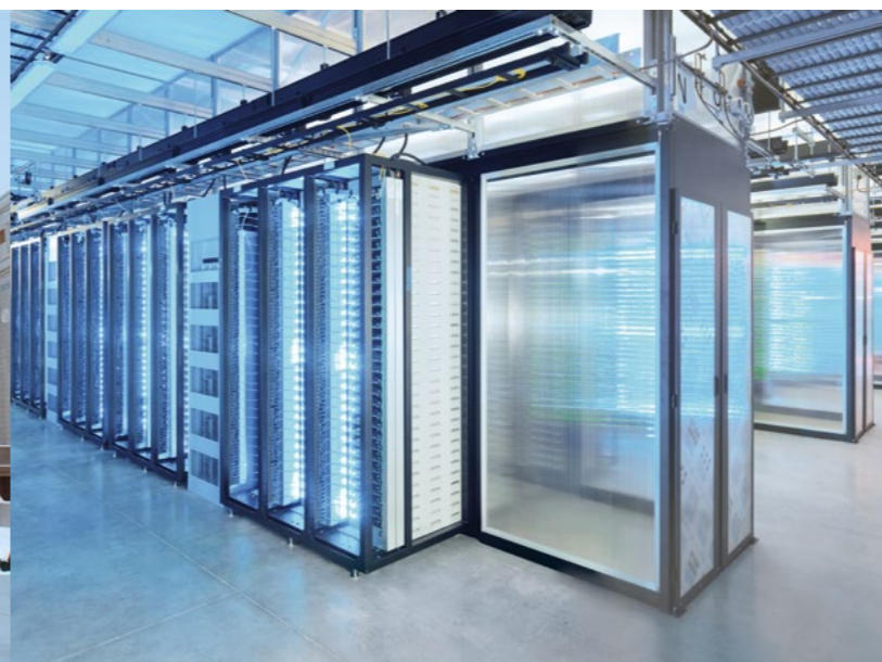
Umidificazione e raffrescamento evaporativo nel data center Meta (Facebook) di Luleå, Svezia
